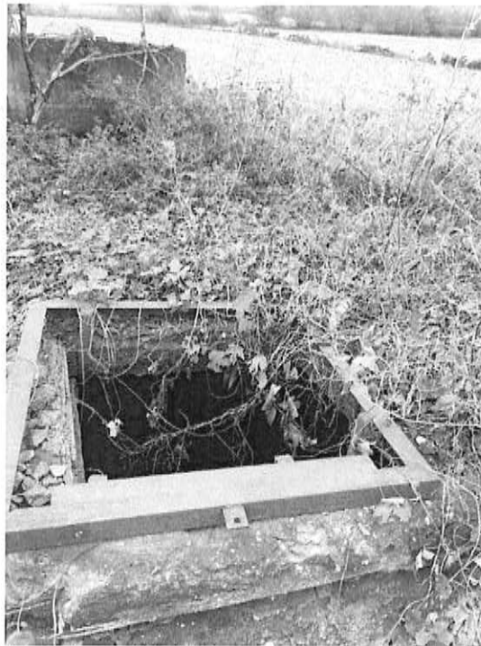
Εικόνα 4-2: Φωτογραφική αποτύπωση Οδού Σ4 – υφιστάμενο φρεάτιο διακλάδωσης.
